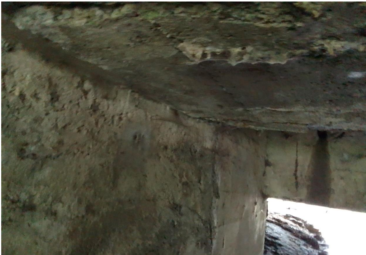
Fot. 4 Korozyjne uszkodzenia betonu płyty betonowej pomostu. Tworzące się nawisy stalaktytowe
