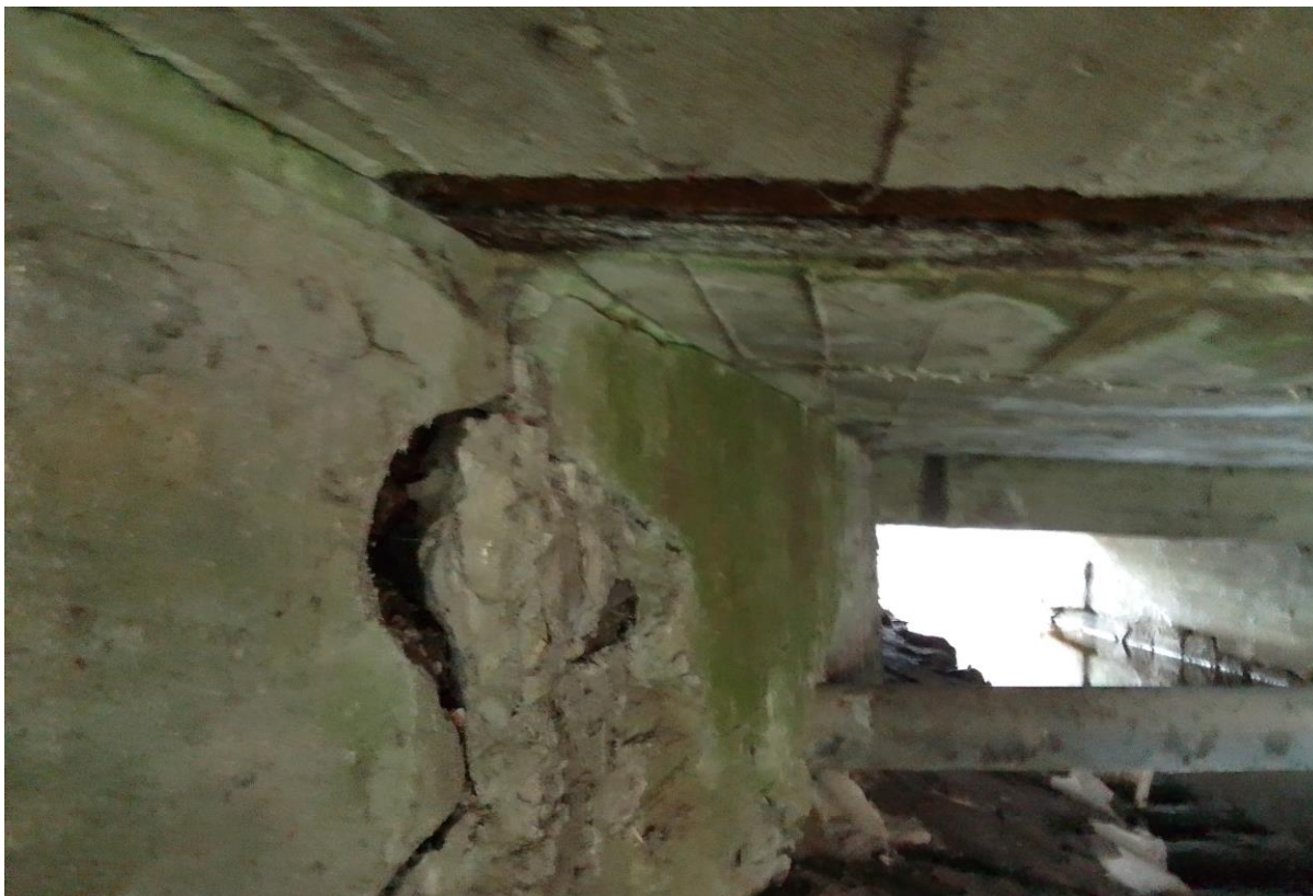
Fot. 2 spód konstrukcji i przyczółek. Widoczne uszkodzenia podstawy posadowienia przyczółka. W części poszerzenia, beton przyczółka ulega poważnej korozji. Wskutek nieszczelnej izolacji płyty pomostu powstają nawisy typu stalaktytowego.
