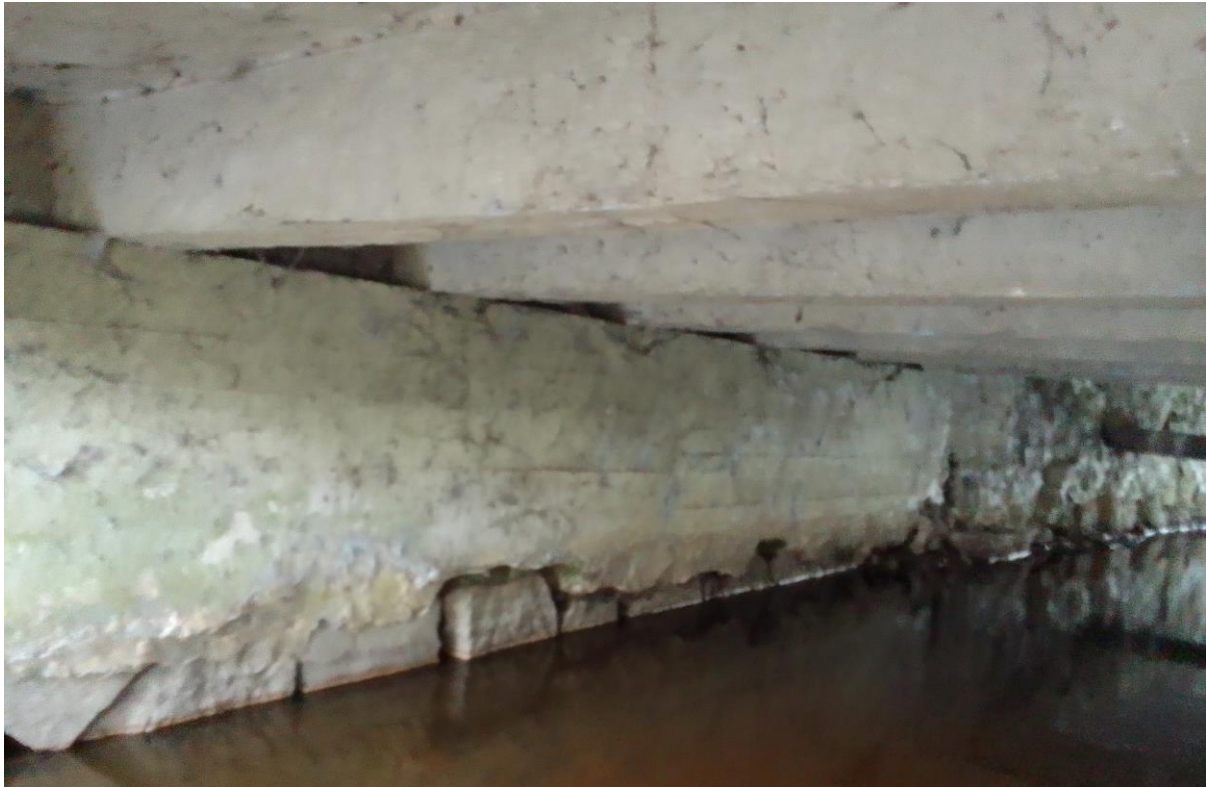
Fot. 3 uszkodzenia i ubytki betonu podstawy przyczółka.
