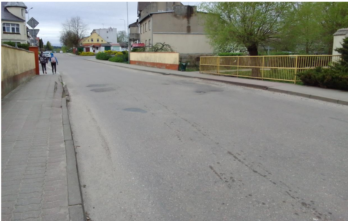
Fot. 1 widok obiektu z poziomu nawierzchni. Nawierzchnia jezdni jest sfalowana, przez co nie jest poprawnie odwodniona. Widoczny po stronie lewej krawężnik i nawierzchnia chodnika są zdeformowane.
