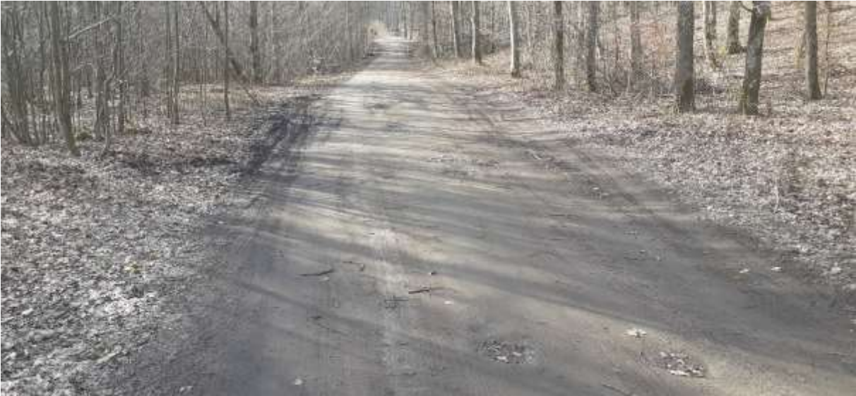
Stan nawierzchni drogi do m. Kaźmierzewo
