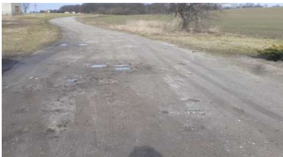
Stan nawierzchni drogi do m. Lubostronie
